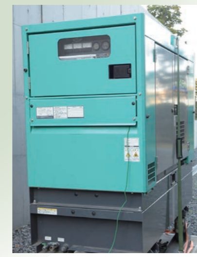
社屋裏のディーゼル発電機も操作手順を常に訓練
