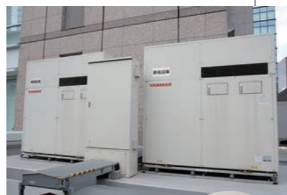
商業棟の屋上に設置された小型発電機
