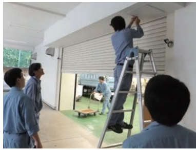
館内設備の確認
