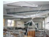
東日本大震災での被害事例
