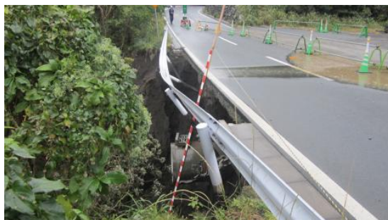
都道の被害状況
