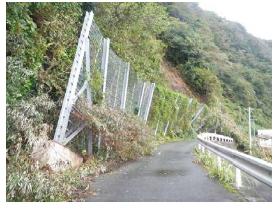
岡田漁港における道路埋塞
