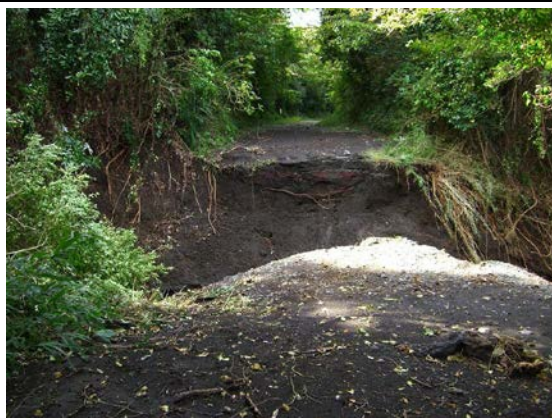
崩落した林道
