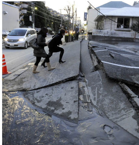
東日本大震災による液状化被害（千葉県浦安市） （写真提供：時事通信社）
