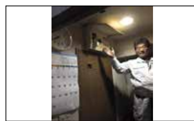
感震ブレーカー設置
