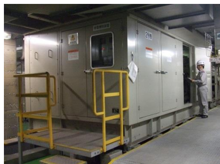
<コージェネレーションシステム>
