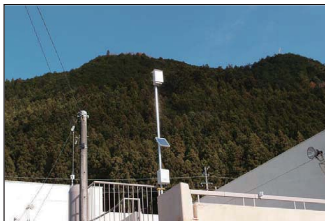
無線中継器設置状況
