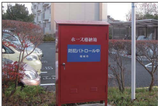
消防ホース格納箱
