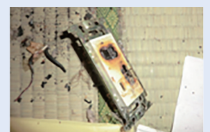
診断で発見したコンセントの焼損痕
