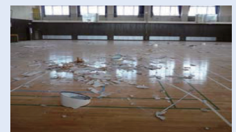
非構造部材落下事例
