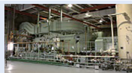
下水道施設の非常用発電機
