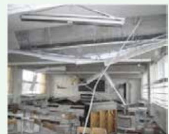
非構造部材落下事例
