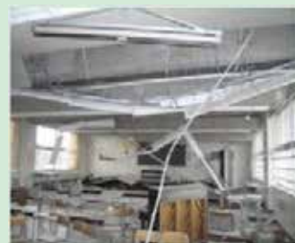
非構造部材落下事例
