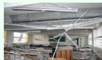
非構造部材落下事例
