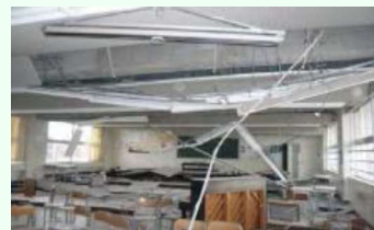
非構造部材落下事例
