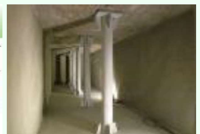
再生された経年防火水槽
