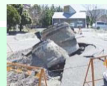
液状化によるマンホールの浮上
