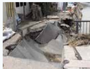
【出典】(一財)消防科学総合センター
