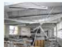
東日本大震災での被害事例
