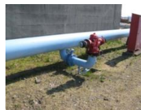
消火用屋外給水施設 （総務省消防庁HPより引用）
