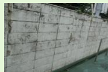
対策が必要なブロック塀
