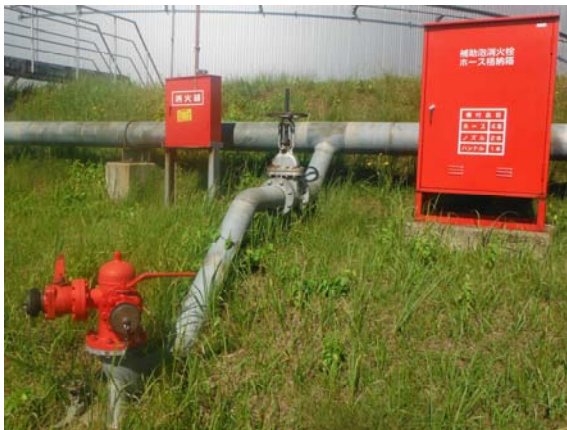
給水栓（消火用屋外給水施設）
