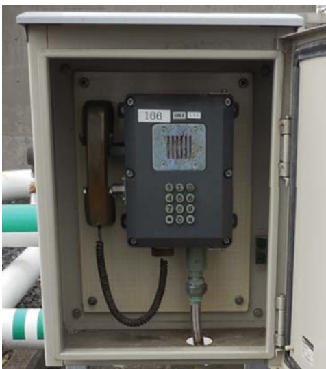
非常通報設備
