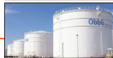
既設タンク(10基)
