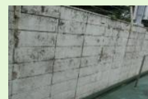
対策が必要なブロック塀
