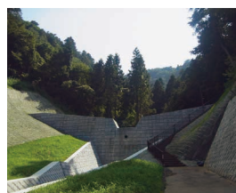
土石流対策(砂防堰堤)
