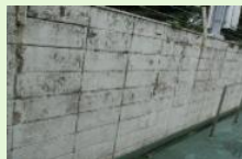
対策が必要なブロック塀
