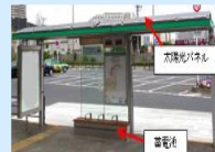
バス停留所に設置された太陽光発電設備
