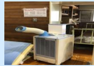
平成30年7月豪雨で設置された冷房
