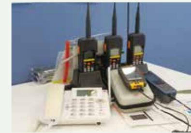
様々な通信障害を想定し多様な機器を用意
