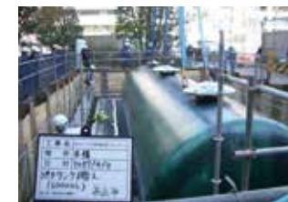
敷地内に埋められている大型重油タンク
