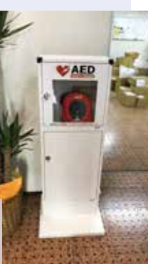
AEDは誰でも一目でわかるよう、玄関ホールに設置している
