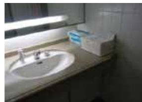
発災時には女子トイレにおいて衛生用品を配備
