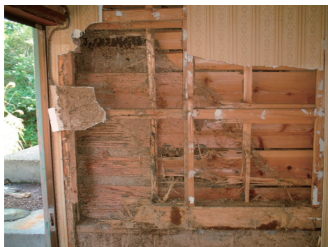
シロアリ被害の様子
