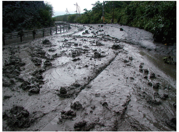
泥流による都道の被害
