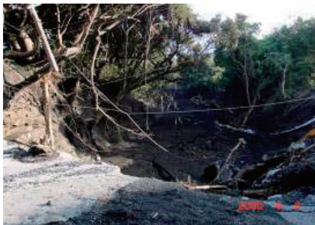
立根付近配電線被災状況
