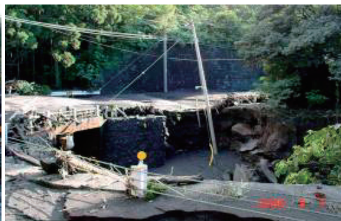
平山橋付近配電線被災状況
