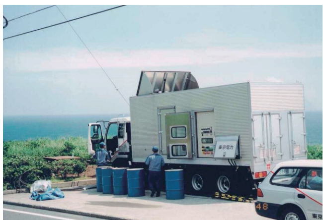
移動用発電設備
