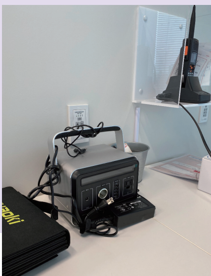
各フロアに1台ずつ配備している
