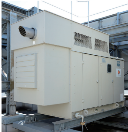
非常用発電機は48時間稼働可能。電力供給停止と同時に自動で稼働する
