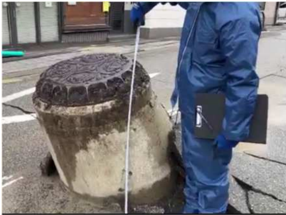
被害状況の確認（輪島市内）
