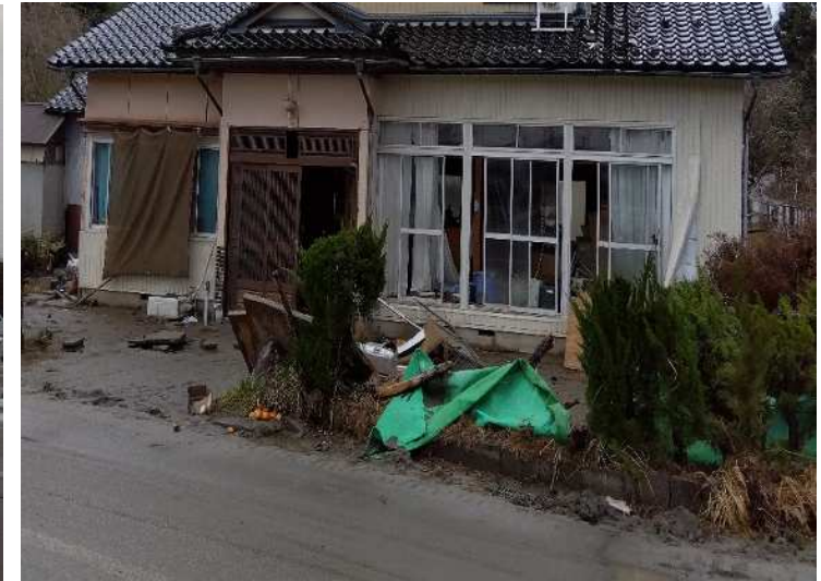
被災家屋の状況（内浦地区）
