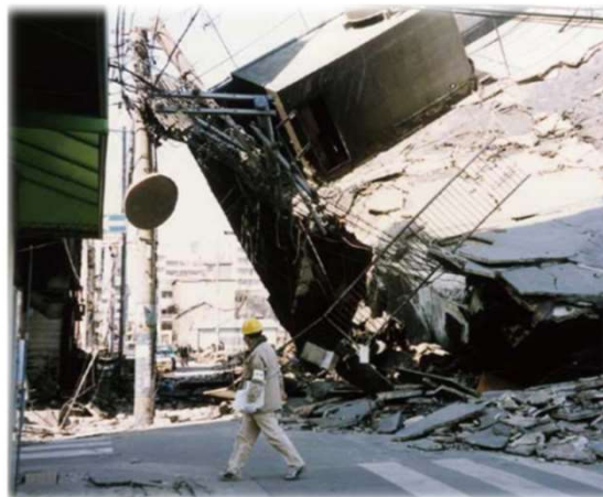
沿道建築物の倒壊による道路閉塞
