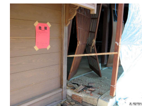
応急危険度判定結果 （一財）消防防災科学センターより
