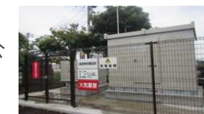
都立公園における 非常用発電機の設置
