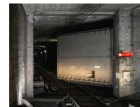
防水ゲート（都営地下鉄トンネル内）
