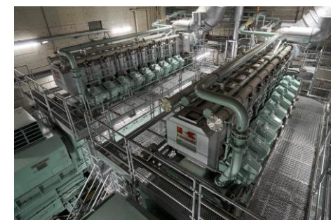
コージェネレーションシステム 提供：東京ガスエンジニアリングソリューションズ 株式会社
