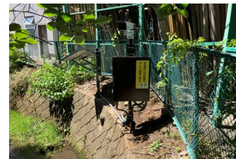
河川監視カメラ 【村山橋（奈良橋川）】
