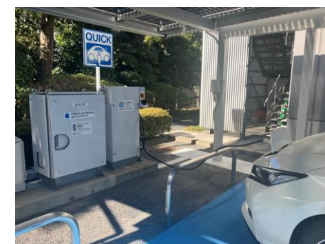
ZEV・外部給電器
