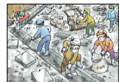
下水管や側溝の詰まりに留意
