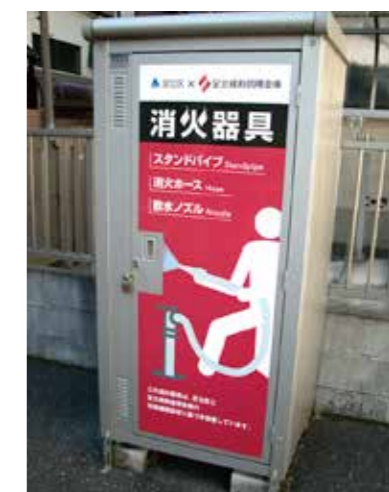
消防車両が入れない路地裏などでの消火活動が可能になるスタンドパイプも同金庫の支店や本店・本部の敷地内に設置。
