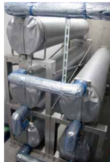
本部ビルの地下に設置された大容量給水タンク「マルチアクア」は、災害時に一時避難者などへ浄水を提供できるシステム。
