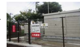
都立公園における 非常用発電機の設置
