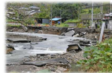
日の出町大久野地区の被災した道路
