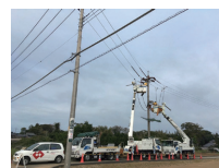
停電からの復旧
