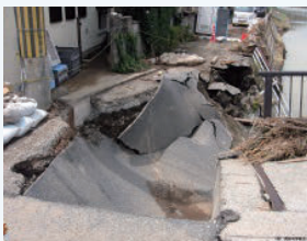
【出典】(一財)消防科学総合センター
