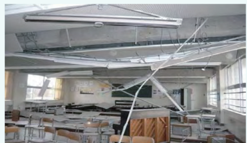
▲非構造部材落下事例
