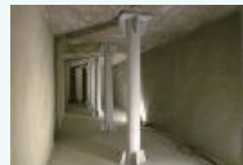
▲再生された経年防火水槽
