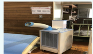
▲豪雨時の避難所で設置された冷房
