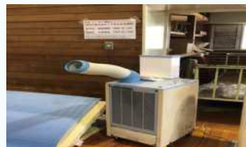
▲豪雨時の避難所で設置された冷房
