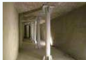
▲再生された経年防火水槽
