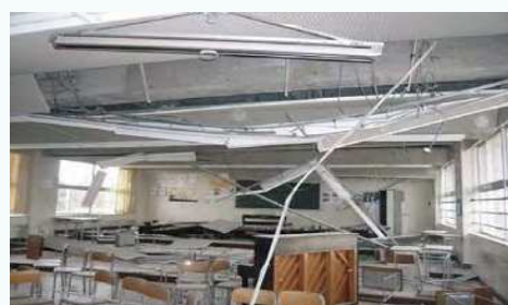
▲非構造部材落下事例
